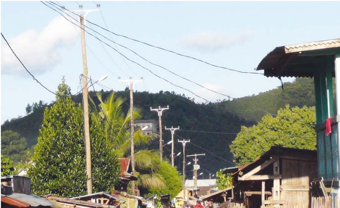
Réseau électrique en moyenne et basse tension sur la rue principale de Tolongoïna
