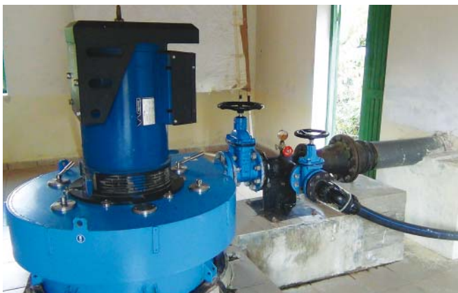
Turbine Pelton installée à Tolongoina
